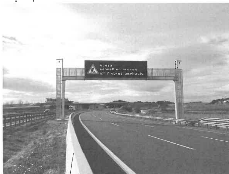
Figura 8 – Panou VMS color, pictograma + text, instalat pe portal (exemplu, sursa: internet)
